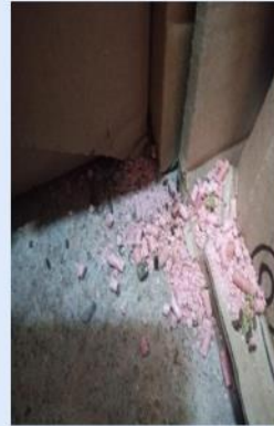
Excremento de roedor y cebo dispuesto directamente sobre la estantería y en contacto directo con las unidades de almacenamiento documental
